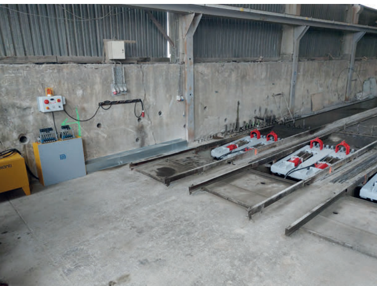
Unidad de bombeo de destensado instalada fija en el lado de destensado
